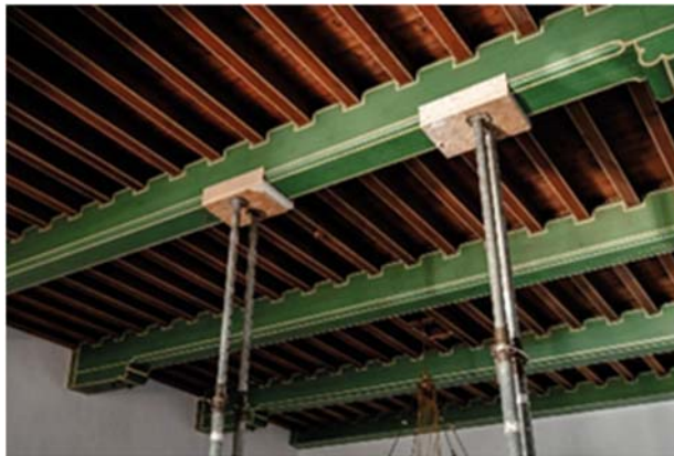
Weeskamer: ondersteuning van het plafond
