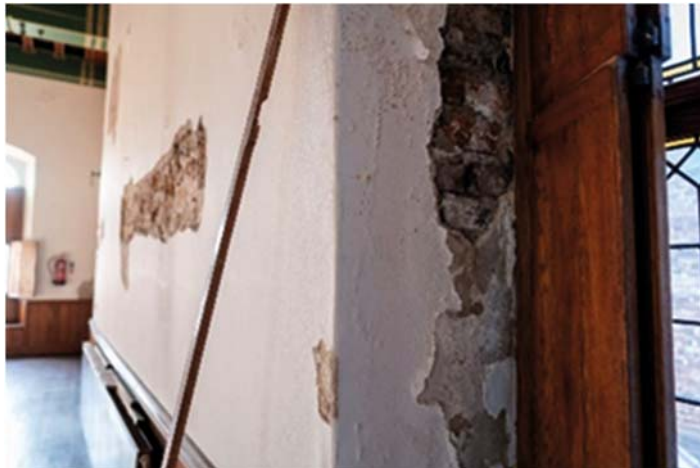
Rolzaal: vochtproblematiek bij kozijnen
