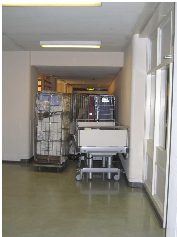
Foto 12: Obstakels in vluchtweg.
