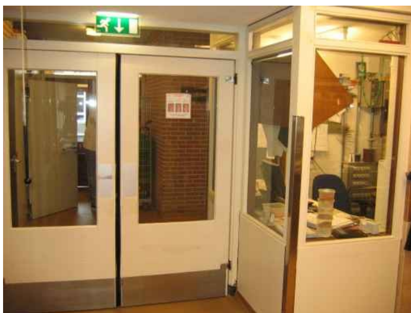
Foto 2: Te grote oppervlakte draadglas in brandwerende scheiding.
