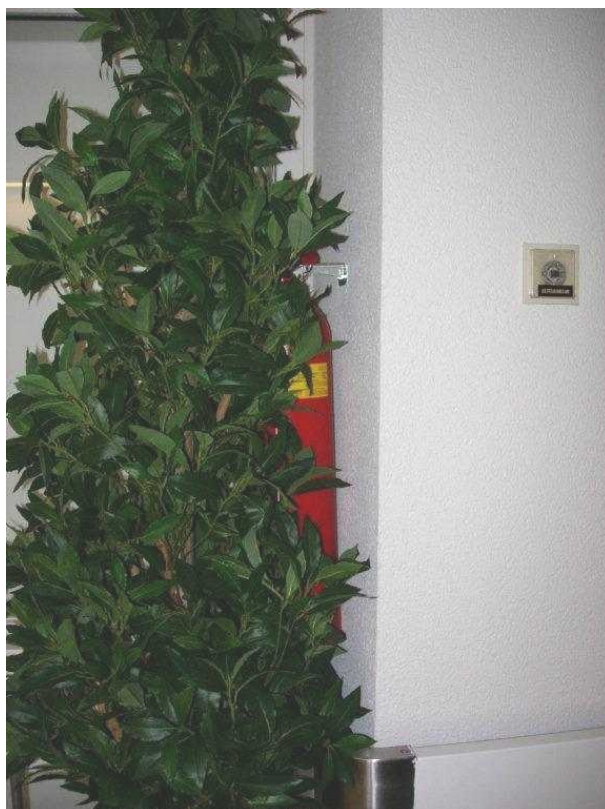
Foto 16: Niet goed zichtbare en bereikbare brandblusser.
