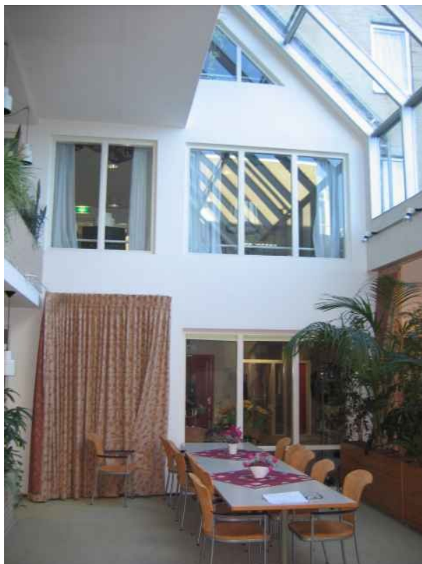
Foto 1: Te grote oppervlakte draadglas in brandwerende scheiding.
