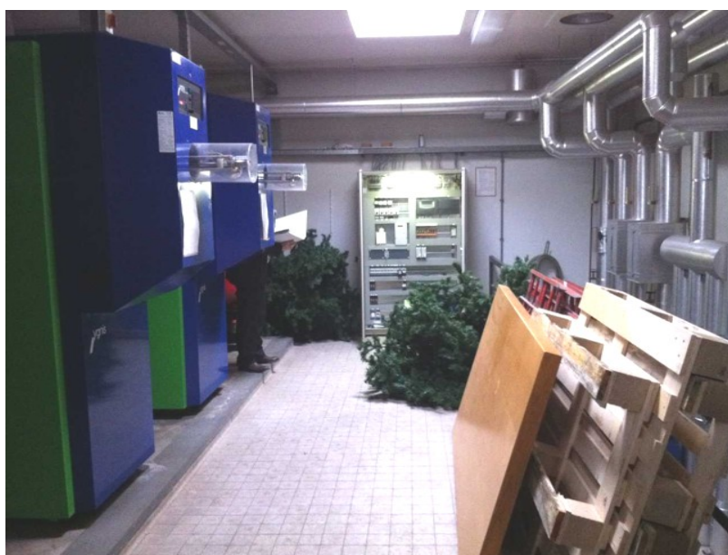
Foto 14: Opslag brandbare materialen in stookruimte.
