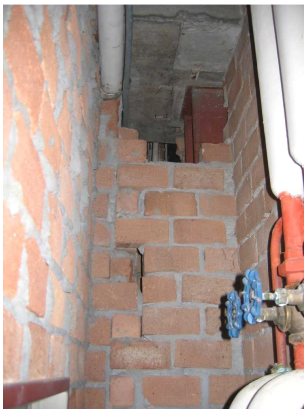
Foto 8: Gat in brandwerende wand van verticale leidingschacht.
