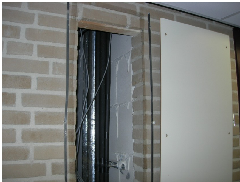
Foto 9: Niet gecompartmenteerde, verticale leidingschacht.
