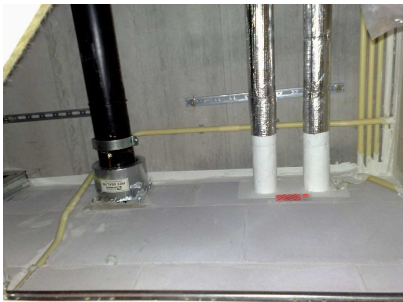
Foto 5: Goed afgewerkte doorvoeren door brandwerende scheiding.
