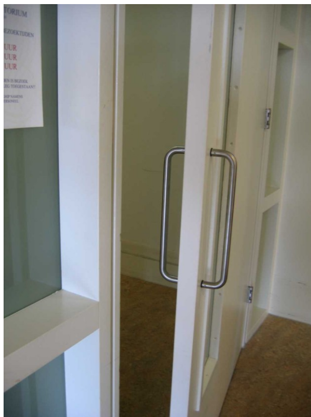
Foto 21: Niet goed sluitende, zelfsluitende deur in brandscheiding.
