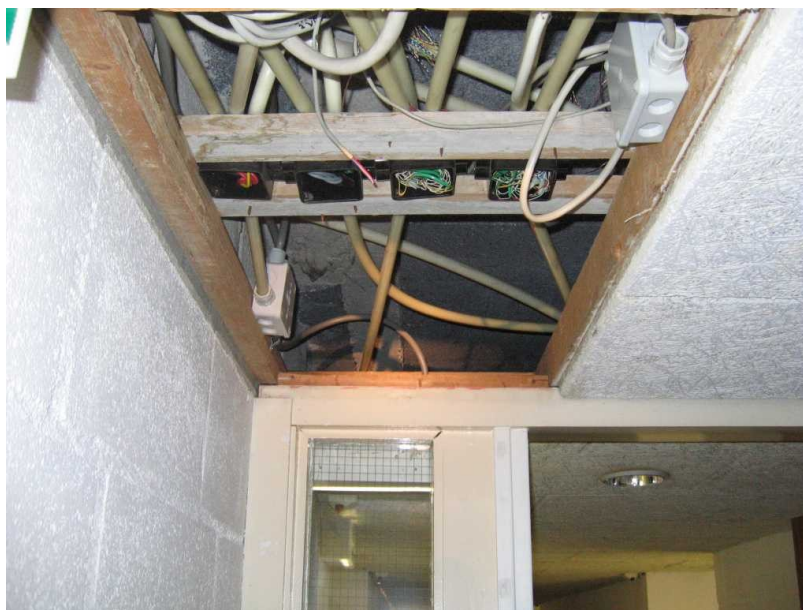
Foto 7: Ontbrekende brandscheiding boven plafond.
