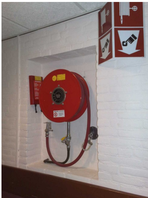
Foto 15: Goed zichtbare en bereikbare brandslanghaspel.
