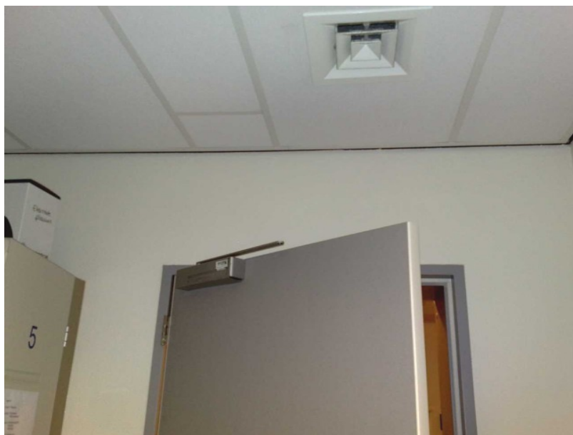
Foto 19: Losgemaakte deurdranger bij zelfsluitende, brandwerende deur.
