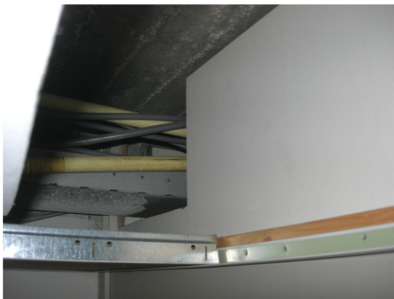
Foto 4: Niet brandwerend afgewerkte brandscheiding boven het plafond.
