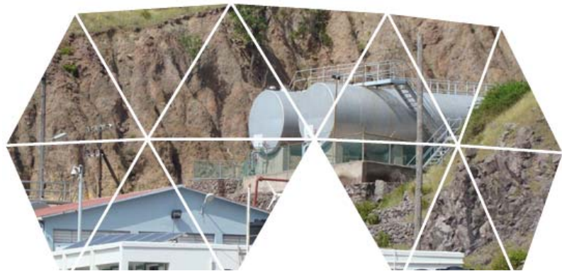
Foto 12: brandstofopslag voor de generator in de haven van Saba.
