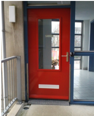
Plaats voor deur en drukknop om deur te openen
