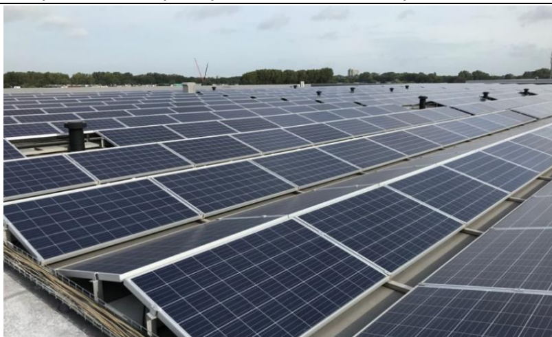
Figuur 3 Zon op dak installatie op bedrijfsdak ABC Westland. Bron: provincie Zuid-Holland
