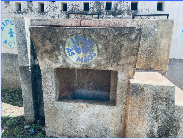
Gestolen kranen in Mozambique.
